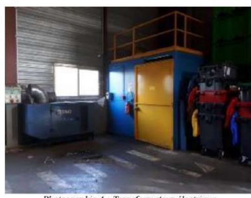
Photographie 4 : Transformateur électrique
