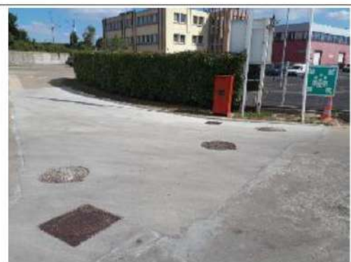
Photographie 2 : Séparateur d'hydrocarbures (Sud)
