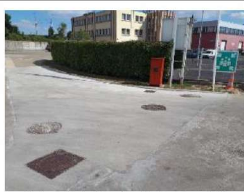
Photographie 2 : Séparateur d'hydrocarbures (Sud)
